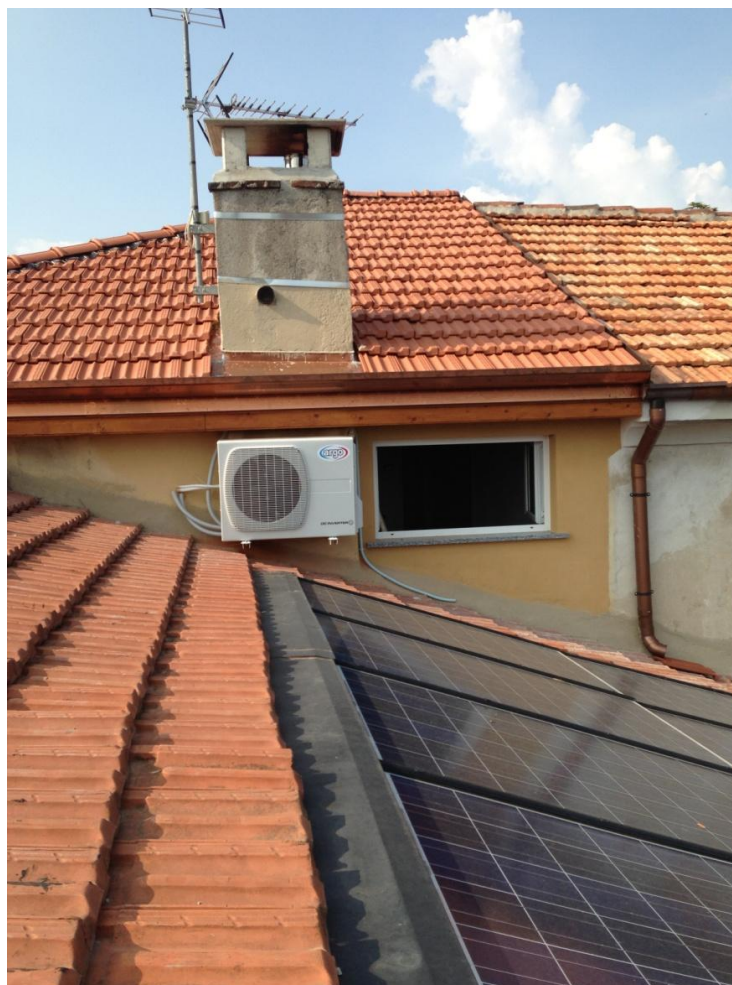
ESEMPIO DI INSTALLAZIONE DI IMPIANTO FOTOVOLTAICO + POMPA DI CALORE REALIZZATO DA EQUA s.r.l
