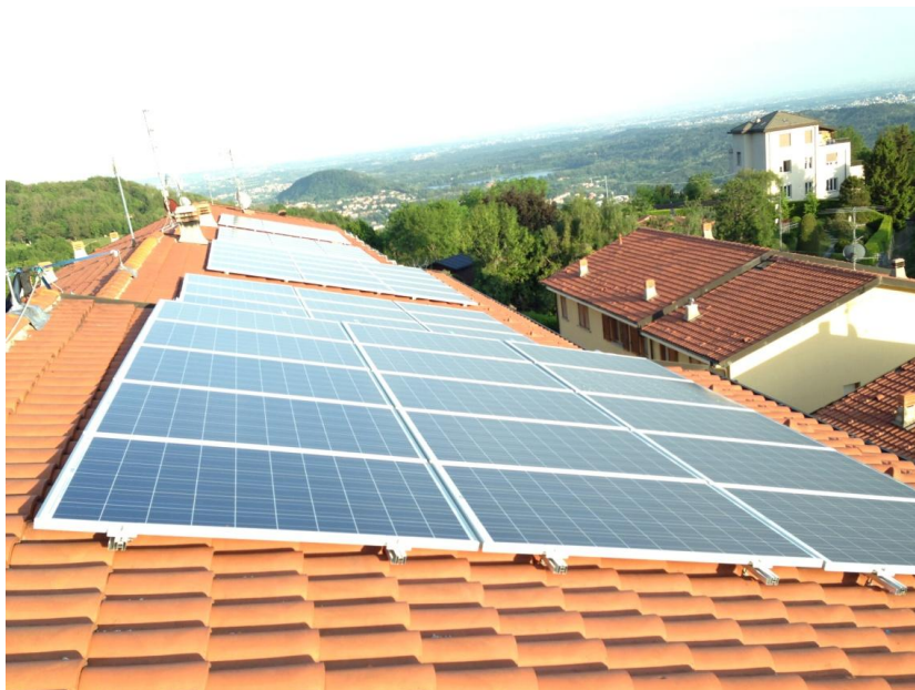
ESEMPIO DI 6 IMPIANTI FOTOVOLTAICI REALIZZATI DA EQUA s.r.l. NEL 2013 PRESSO CIVIGLIO (CO)
